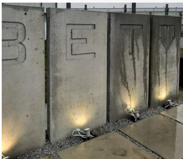
Obr. 9. Vlevo stěny naimpregnované, vpravo bez impregnace
